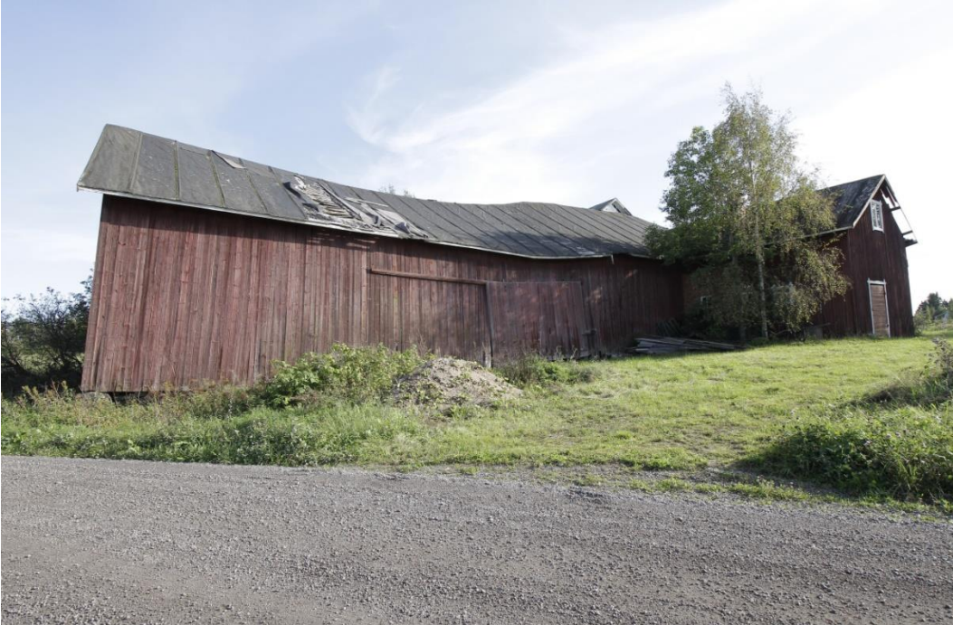
Kuva 100 Nurmintien varressa sijaitsee tilan entinen kookas lato. Sen vesikatto on heikossa kunnossa. Tien varren rankorakenteisen osan katonharjan on painunut.
