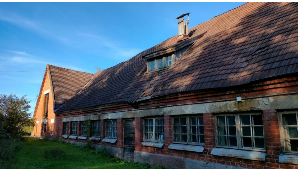
Kuva 105 Suuren tiilinavetan länsijulkisivu. Navetan ikkuna-aukot on holvattu betonipalkilla, perustuksina on käytetty porakiviä. Navetan vesikate on heikossa kunnossa ja kattorakenne on paikoin painunut.
