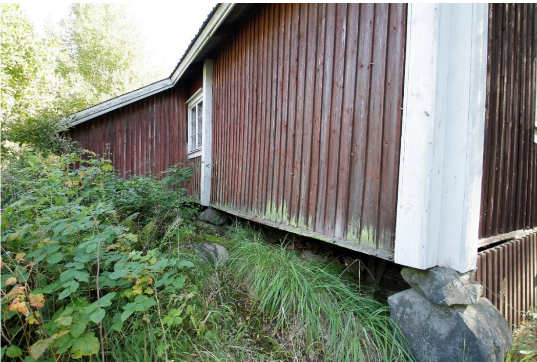
Kuva 135 Hirsirakennuksen ympäristö on kasvamassa umpeen ja rakennuksen nurkat ovat hieman painuneet.
