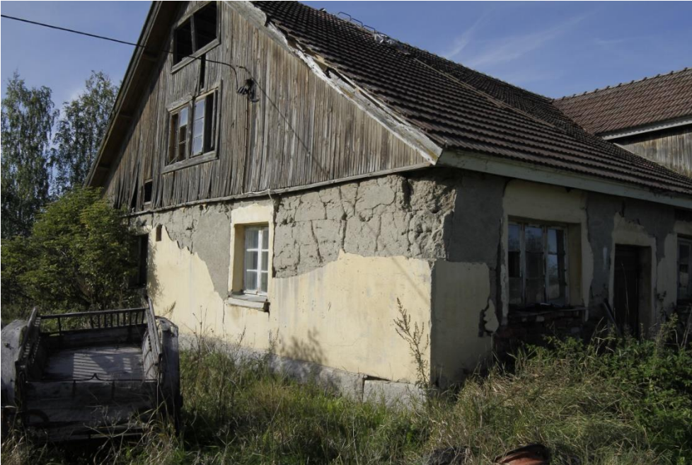
Kuva 97 Kovapään vanha navetta on vuodelta 1923. Navetta on rakennettu harvinaisesta materiaalista, savi-kanerva –seoksesta. Rakenteen rappaus on pahoin rapistunut.
